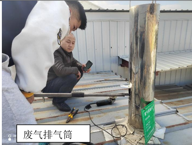
图 3-4 废气排气筒照片
